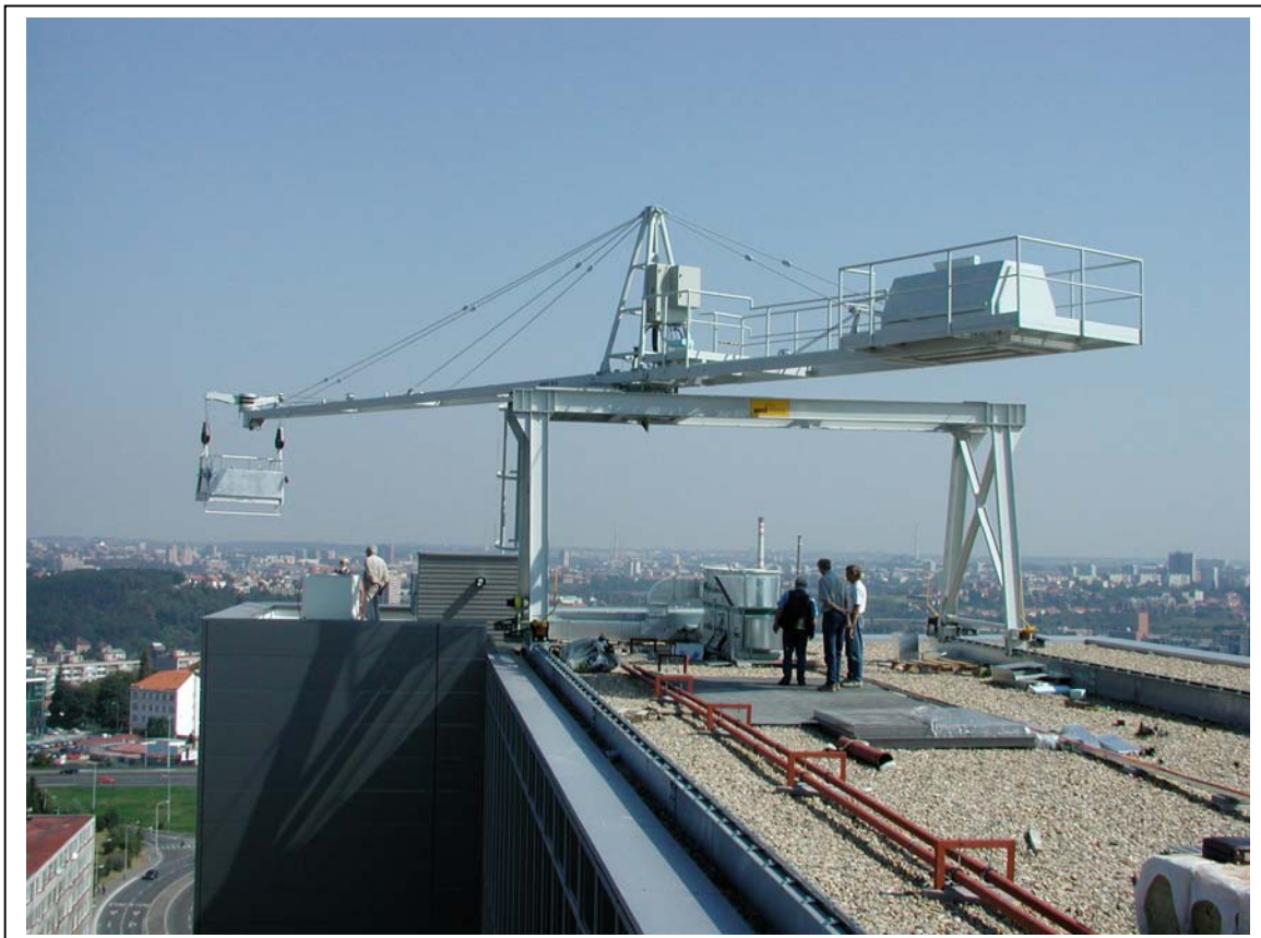
Zařízení pro přístup k obvodovým plášťům objektu Reiffaisen v Praze
